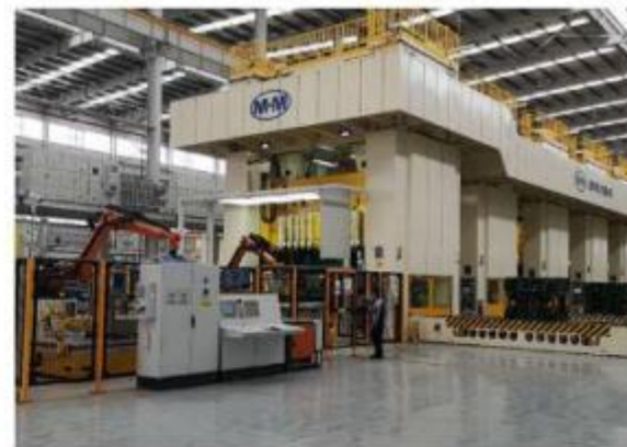
嘉润汽配公司 (机器人冲压线)
