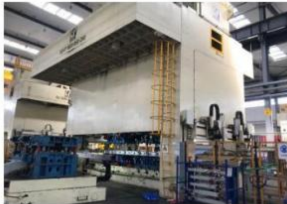
英利汽车工业公司 (多工位冲压线)
